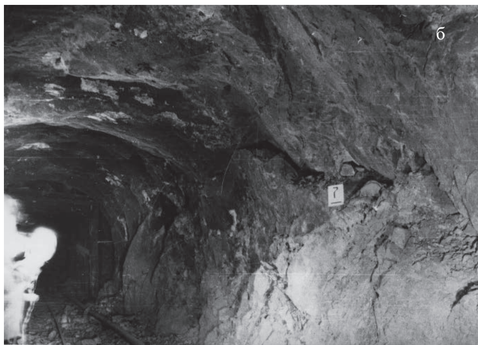
Рис. 7. Раскрытие тектонической трещины в стене штольни в результате подземного взрыва: а – пикет ПК105 м, б – ПК127 м. Глубина от дневной поверхности около 150 м. Величина максимальной скорости смещения грунта ~18–25 м/с
